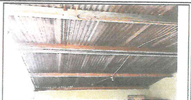
Foto 2: Estructura de soporte dañada por lluvia y antigüedad
